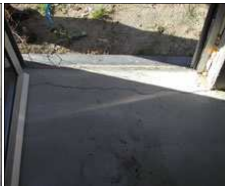
Scheur ter hoogte van een deuropening wegens het ontbreken van een voeg.
