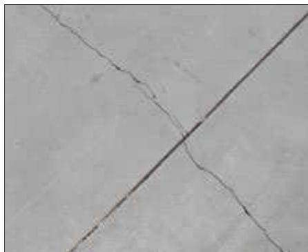
Scheurvorming over de zaagsneden duidt meestal op de aanwezigheid van plastische krimpscheuren.
