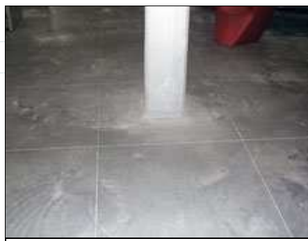
Afb. 1 Verschil in oppervlakteruwheid ter hoogte van een kolom.
